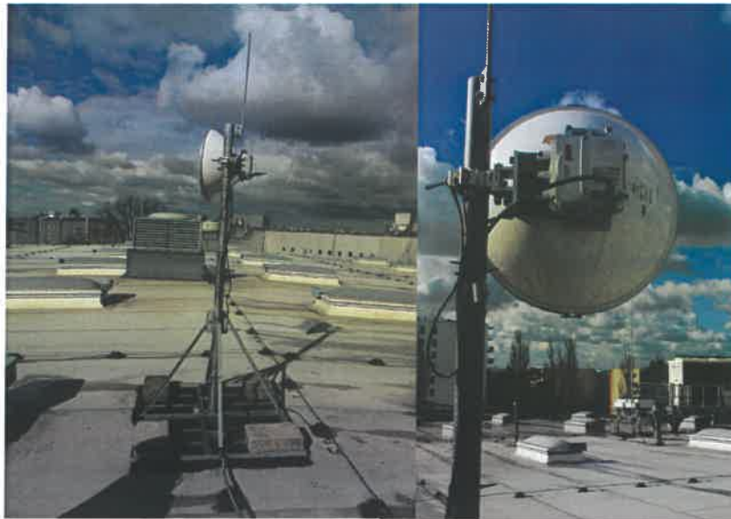
Widok obiektu wraz z zainstalowanym zespołem antenowym
